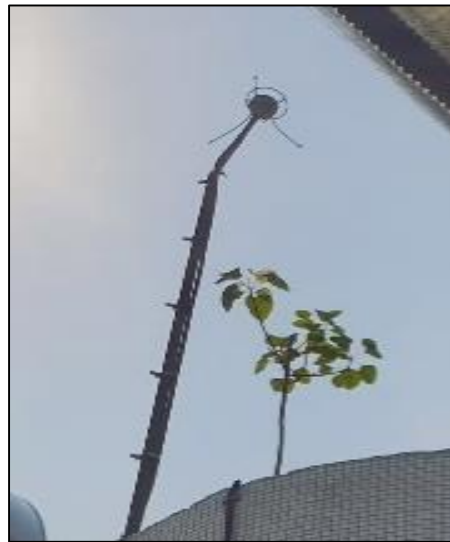
Tiang APK yang mengandungi bahan radioaktif bengkok dari pemasangan asal.
